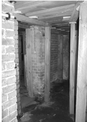
In der Wühlischstr. 42 muss die Kellerdecke zurzeit provisorisch abgestützt werden.
